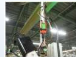
写真1. 設備側 IoTデバイス
